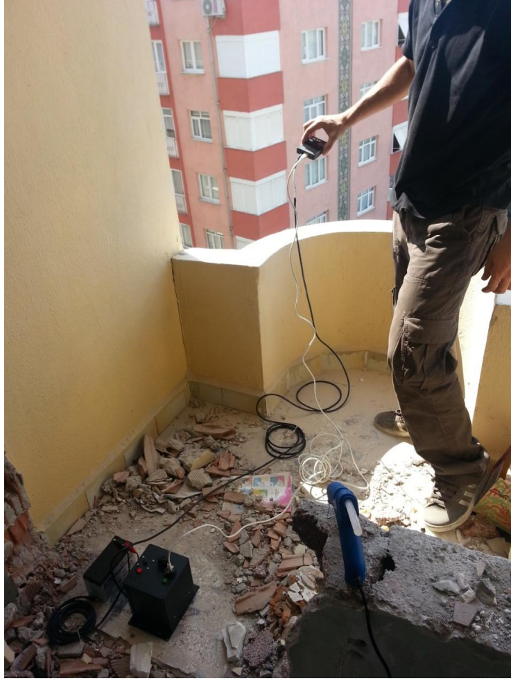
Şekil 3.2 - Sensör, akü ve kablosuz veri aktarıcının yerleştirilmesi
